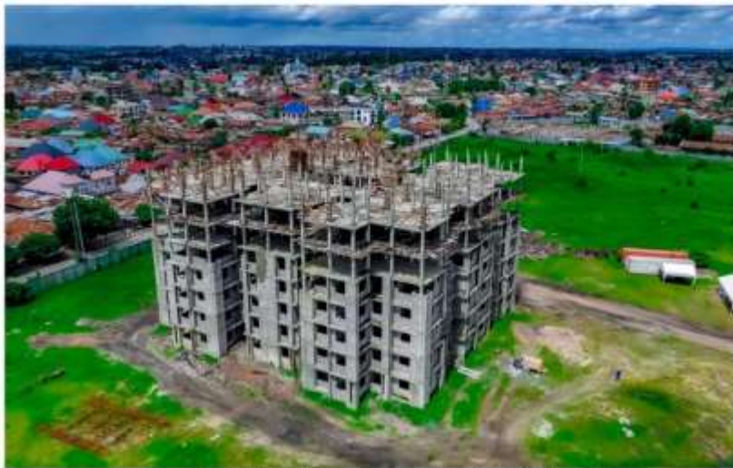
Muonekano wa mradi wa ujenzi wa nyumba za makazi 144 za gharama nafuu zinazojengwa na Wakala wa Majengo Tanzania (TBA) Wilayani Temeke jijini Dar es Salaam.
