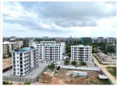
Muonekano wa nyumba za makazi za "Canadian Village", zilizopo Masaki Lindi zinazojengwa na Wakala wa Majengo Tanzania (TBA) Mkoani Dar es Salaam.
